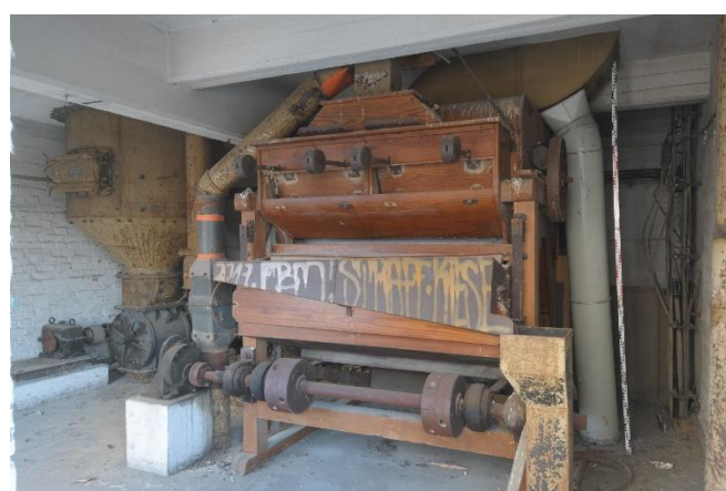
Abb. 4: Reinigungsmaschine, im Hintergrund Rezipient der Schiffsentladung.
