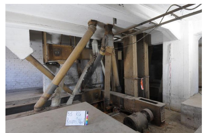
Abb. 5: Transportmaschinen (Becherwerke, Trogkettenförderer, Verteilrohre).
