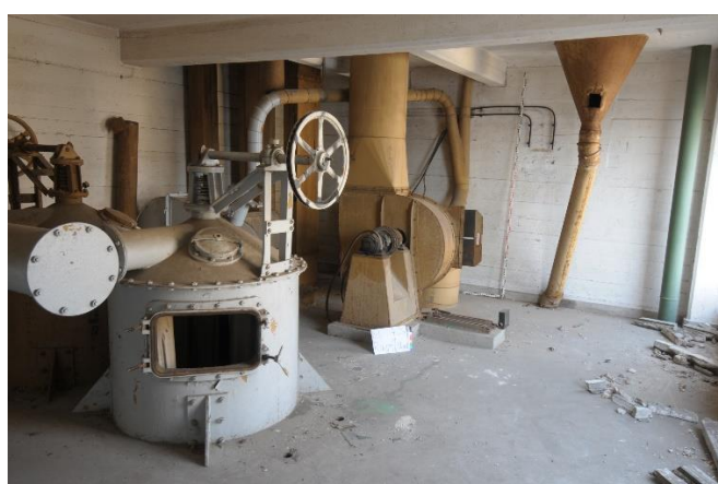
Abb. 3: Staubfiltermaschine und Ventilator der Reinigungsmaschine.
